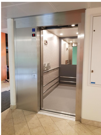
Smedjevägen 1 och 23 samt Häggviksvägen 19 har nyrenoverade hissar.
