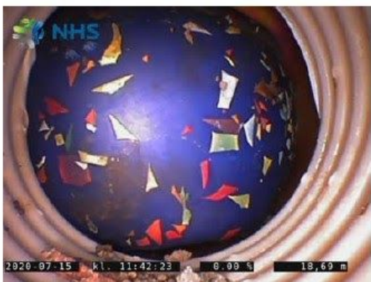
Foto: NHS, Främmande föremål blockerar dräneringsrör
