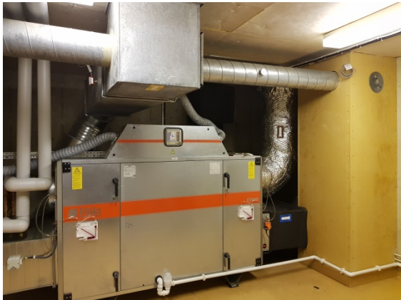
Tilluftsggregatet i reglercentralen förhindrar att kall luft sugas in i bostäderna på vintern.
