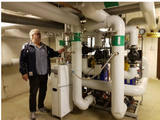
Avgasare och radiatorslinga i reglercentralen. Avgasaren renar vattnet i radiatorslingan och eliminerar luft så att rostangrepp inte skapas.
